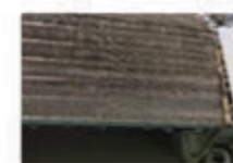
Etap 1 Zabrudzona jednostka wewnętrzna klimatyzatora
